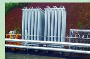
LNG Regas Skid
