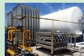
LNG Modular Station
