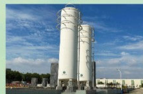
LNG Bulk Storage Tank
